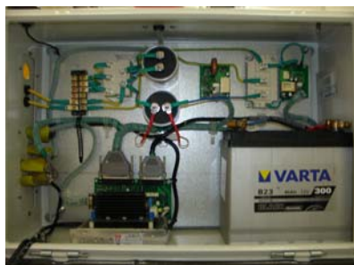
Рис. 12. Вид внутреннего устройства электрошкафа управления (ЭШУ)
